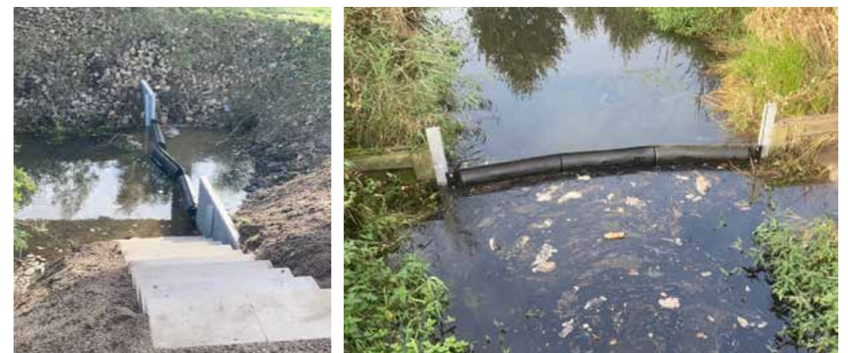
Bild: Öl-/Unratsperren zum Zitadellenteich und Zitadellengraben
