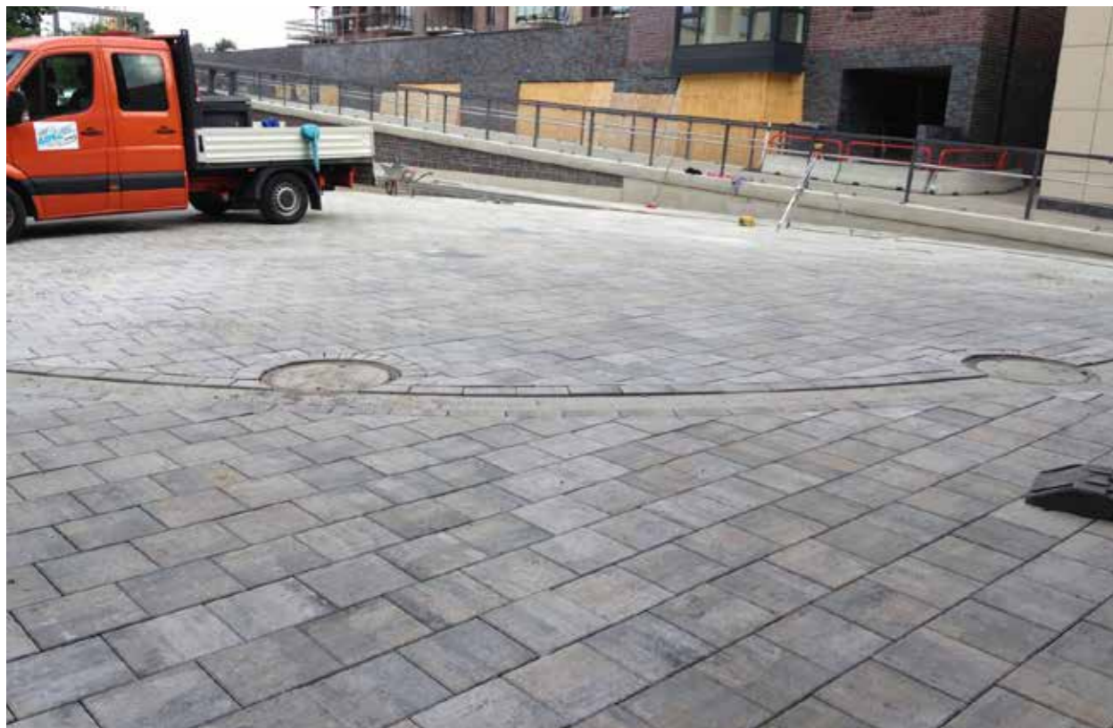
Stichstraße „Neuer Markt“ Wendehammer in Blickrichtung Widerlager Ost / Stadthäuser. Oberflächenbefestigung - Pflaster in Muschelkalkoptik.
