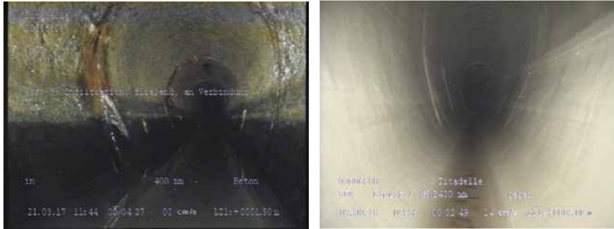
Eiprofil aus Beton mit starker Grundwasserinfiltration an den Verbindungen vor (links) und nach (rechts) der Sanierung
