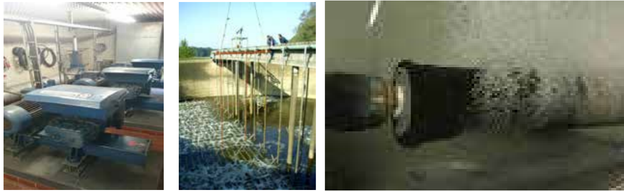
Gebälse, Rohrleitungssystem und Belüfterkerzen bilden das Belüftungssystem
